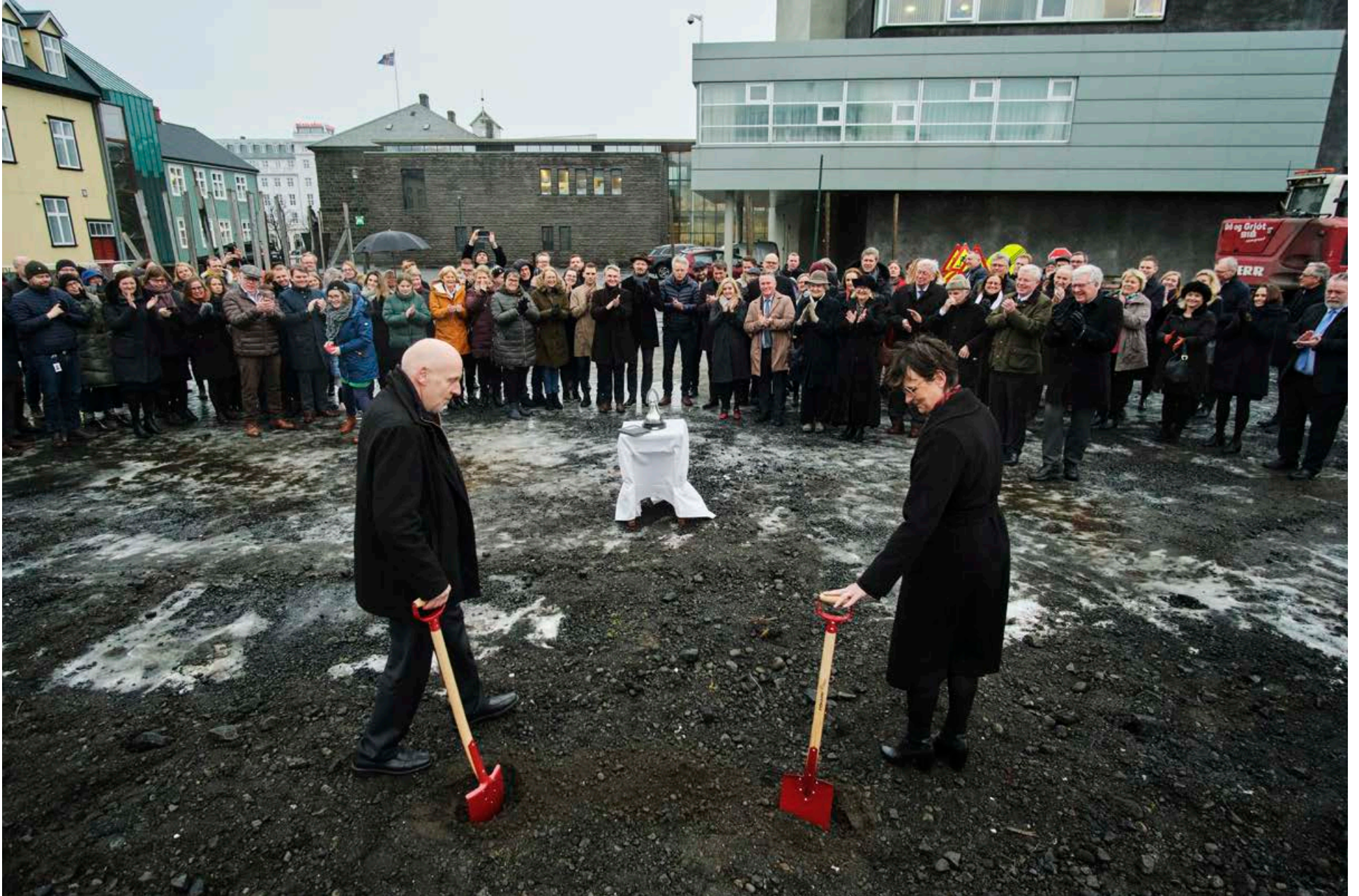
Það var hátíðleg stund þegar Steingrímur J. Sigfússon, forseti Alþingis, og Ragna Árnadóttir skrifstofustjóri tóku skóflustungu að nýbyggingu á Alþingisreit í gær. Það markaði upphaf framkvæmda við 6.000 fermetra nýbyggingu Alþingis. Þar verða skrifstofur þingmanna, aðstaða fyrir þingflokka, fundarherbergi nefnda, ráðstefnuaðstaða og margt fleira. Kostnaður er áætlaður um 4,4 milljarðar króna. Þetta er mesta framkvæmd á vegum Alþingis í 140 ár, eða allt frá því að sjálft Alþingishúsið var reist á árunum 1880–1881. FRÉTTABLAÐIÐ/ANTON BRINK
