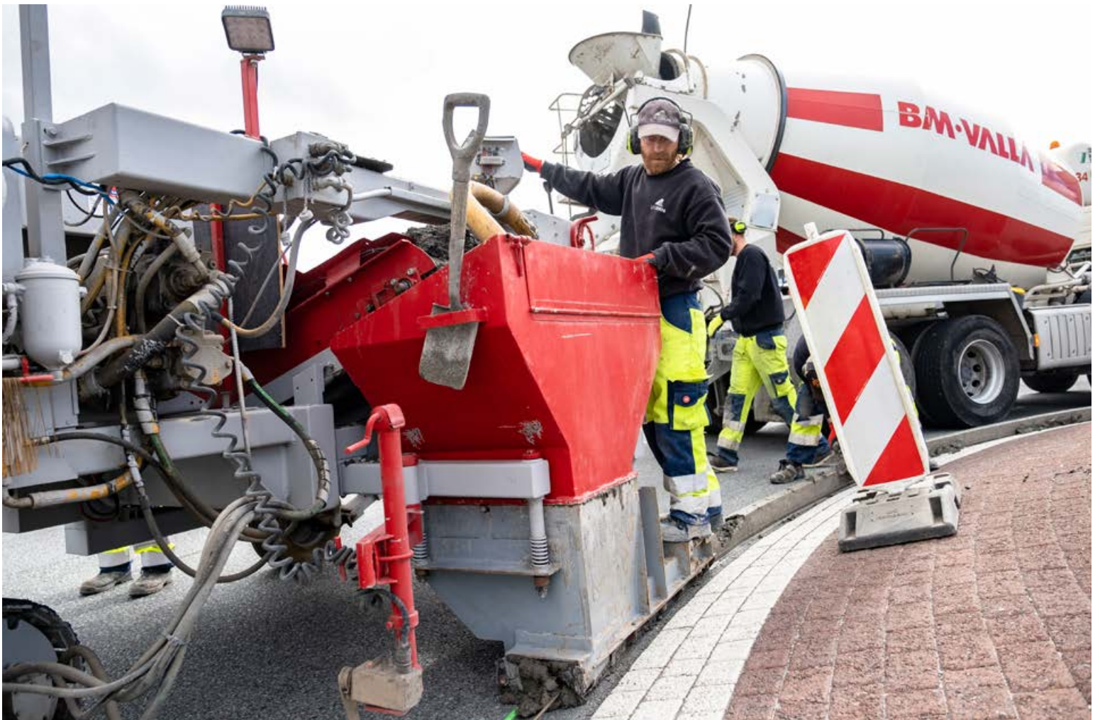
Starfsmenn BM Vallár voru í óða önn að steypa kantstein við hringtorg í Hamraborg í Kópavogi í gær. Sumartíminn er alla jafna nýttur eins vel og nokkur kostur er til þess að lappa upp á veðurbarnar götur landsins og nú var komið að nauðsynlegum steypuframkvæmdum. FRÉTTABLAÐID/ERNIR
