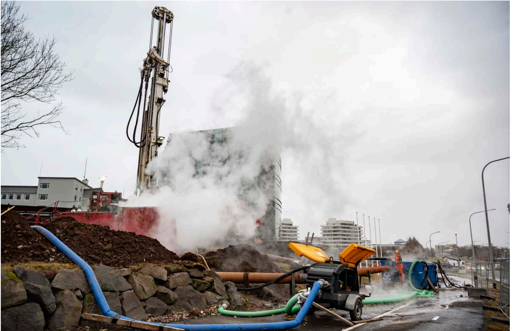
Jarðborinn Nasi, sem er einn stærsti bor sem sést hefur í Reykjavík í áratugi, vinnur að því að auka afkastagetu gjöfulustu heitavatsborholu Veitna sem staðsett er við Bolholt og hefur þjónað borgarbúum frá árinu 1963. „Framkvæmdin hefur gengið vel en vinna við hreinsiborun hefur dregist,“ segir Breki Logason, upplýsingafulltrúi Veitna. FRÉTTABLAÐIÐ/SIGTRYGGUR ARI
