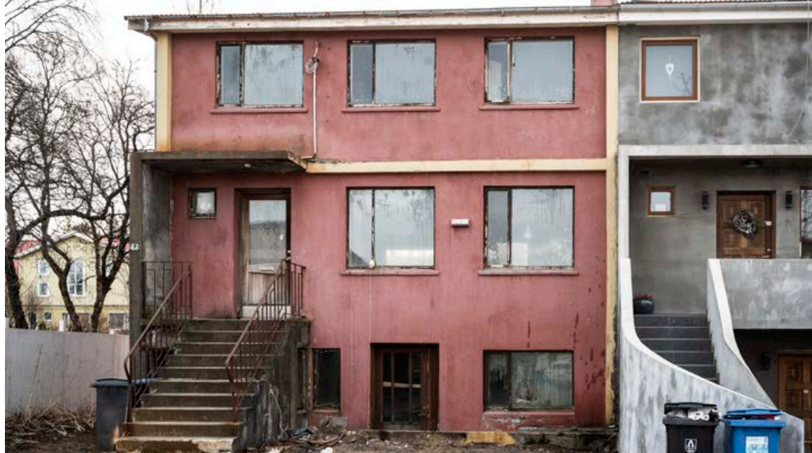
Ástandið á Skólagerði 47 er vægast sagt bágborið að utan og ekki tekur betra við innandyra. FRÉTTABLAÐIÐ/SIGTRYGGUR
