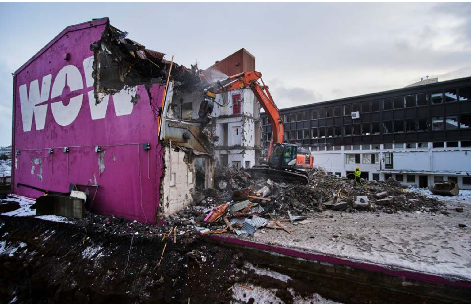
Vinnuvélar í óðaönn við að jafna gömlu höfuðstöðvar WOW air við jörðu. Ásamt gömlu bælistöðvum flugfélagsins hefur Byggingafulltrúinn í Reykjavík heimilað niðurrif á tveimur húsum á reitnum. Fáist heimild stendur þar til að reisa átta hæða atvinnuhúsnæði. FRÉTTABLAÐIÐ/ANTON BRINK
