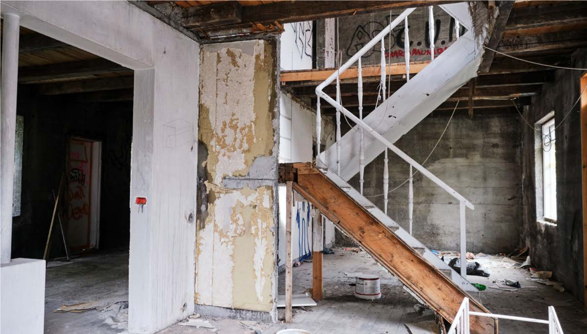
Íbúar við Óðinsgötu segja tvö hús við götuna í því líkri niðurniðslu að þeir skammist sín fyrir að búa nálægt þeim. Húsin hafa verið umsjónarlaus í fjögur ár og ekkert er gert. SJÁ SIÐU 2. FRÉTTABLAÐIÐ/VALLI
