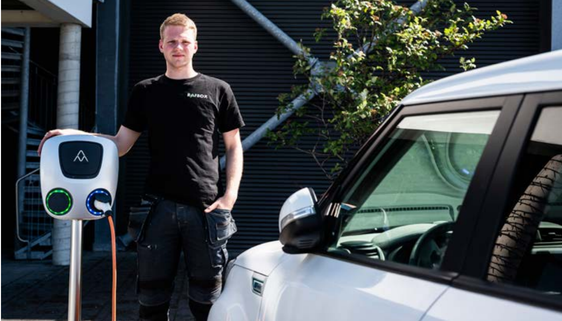
Júlíus Freyr er einn eigenda Rafbox sem setti upp glæsilegar hleðslustöðvar fyrir rafbílaflota A4 fyrir stuttu.
